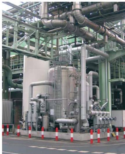
Abb. 3: Maßgeschneiderte Kühlanlage zur Spitzenlastabdeckung mit 200 kW Kühlleistung
