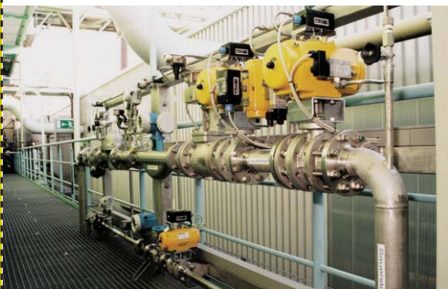
Anlage zur Regelung der Sauerstoffeinspeisung
